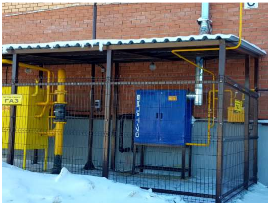
Рисунок 62 – Внешний вид конденсационных котлов наружного размещения на фасаде.
