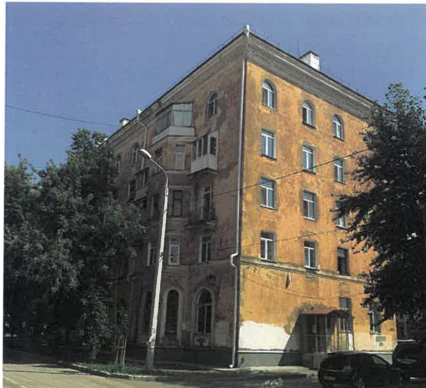
Главный фасад (в осях Е-А; со стороны улицы Юрия Смирнова) (существующее положение)
