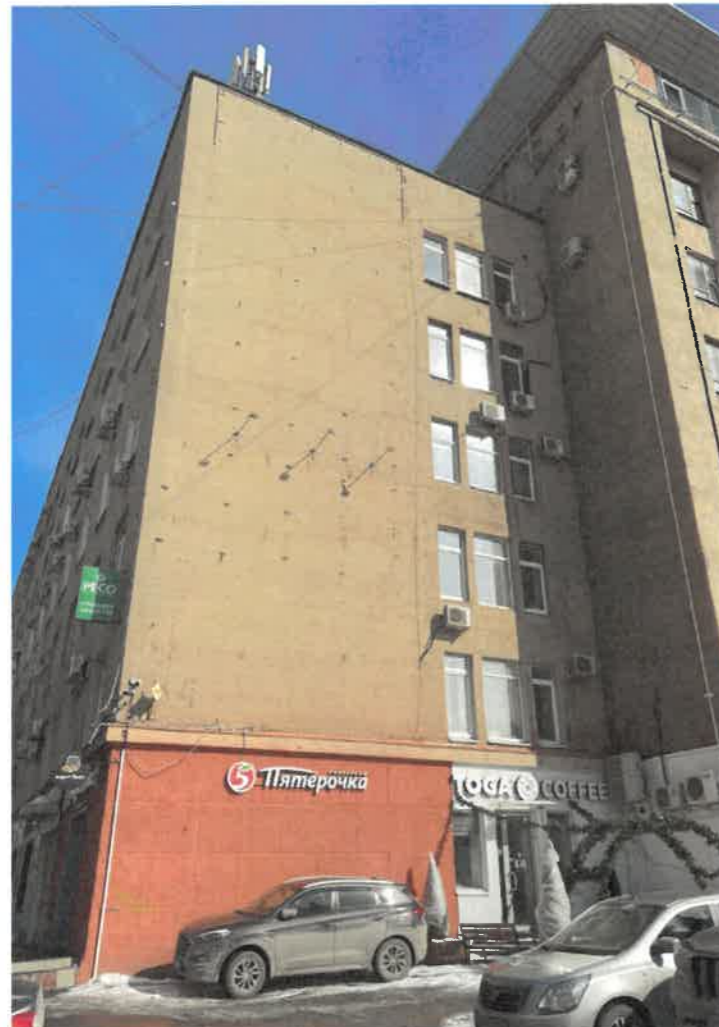
Боковой фасад в осях А-Б
