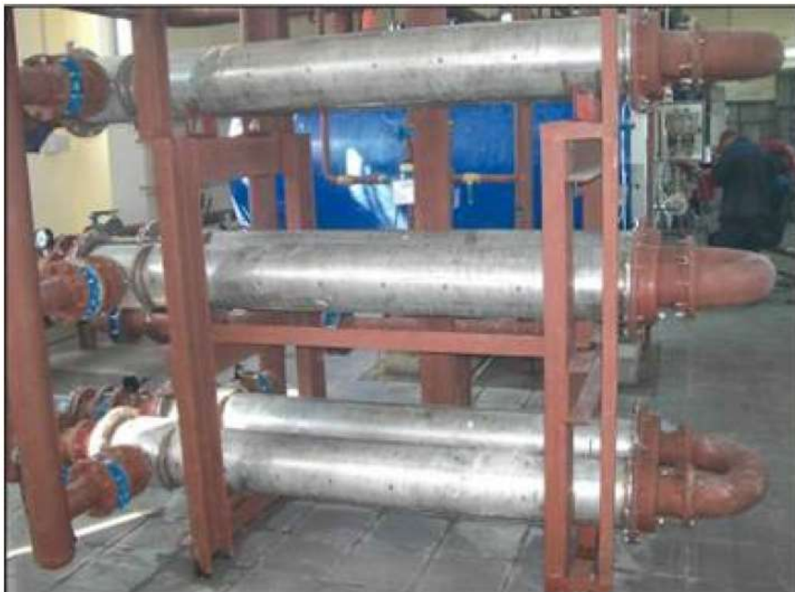
Рисунок 7 - Теплообменники ВВПИ в котельной МУП "Теплосервис"
