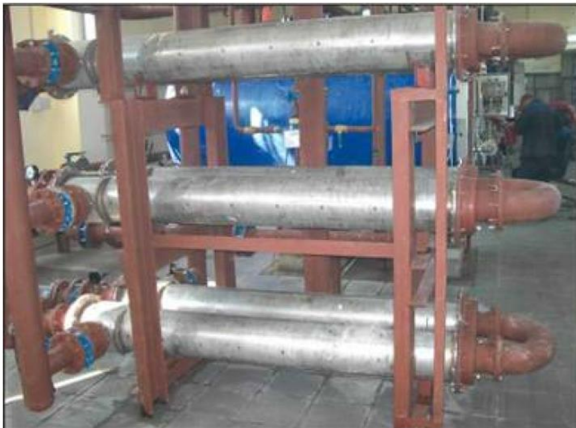
Рисунок 7 - Теплообменники ВВПИ в котельной МУП "Теплосервис"
