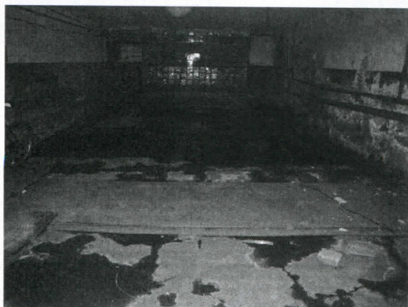
Встроенные помещения, общая площадь 205,9 кв. м., в подвале 3-этажного кирпичного жилого дома (лит.А), адрес объекта: Пермский край, г. Пермь, ул. Сухумская, д.4а
