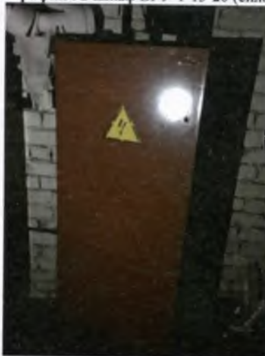
Фотография 92 Шкаф ВРУ-1-13-20 (силовой)
