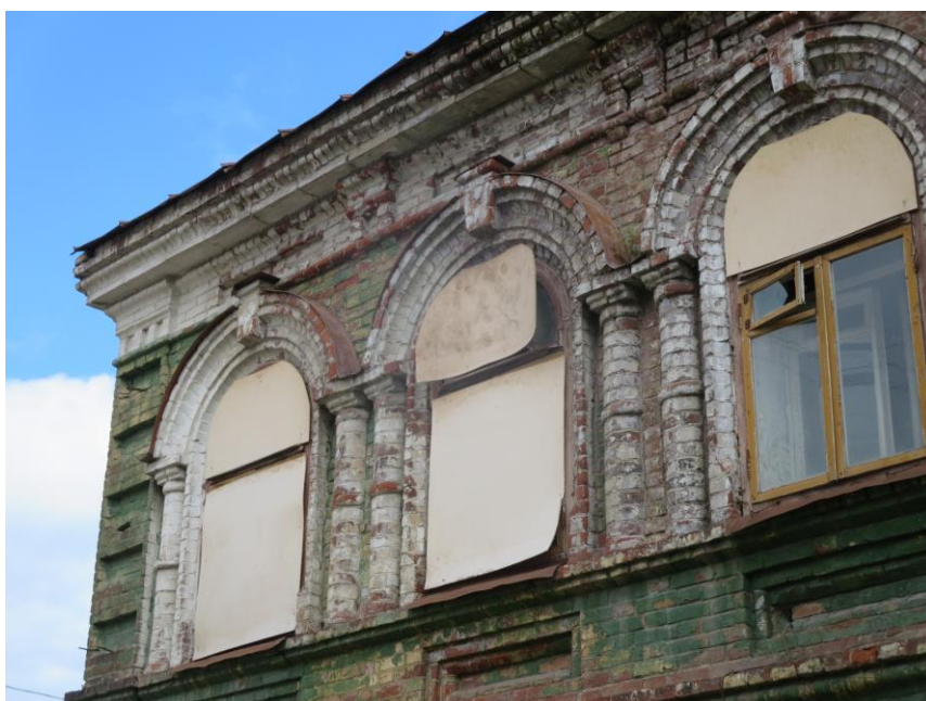
Фото 15. г. Пермь, ул. 25 Октября, 47. «Дом Грацинского». Следы переувлажнения, шелушения покрасочного слоя.
