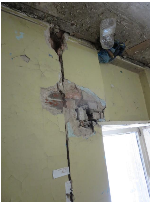
Фото 20. г. Пермь, ул. 25 Октября, 47. «Дом Грацинского». Интерьер. Второй этаж. Помещение 2. Трещина с раскрытием по деформационному шву.
