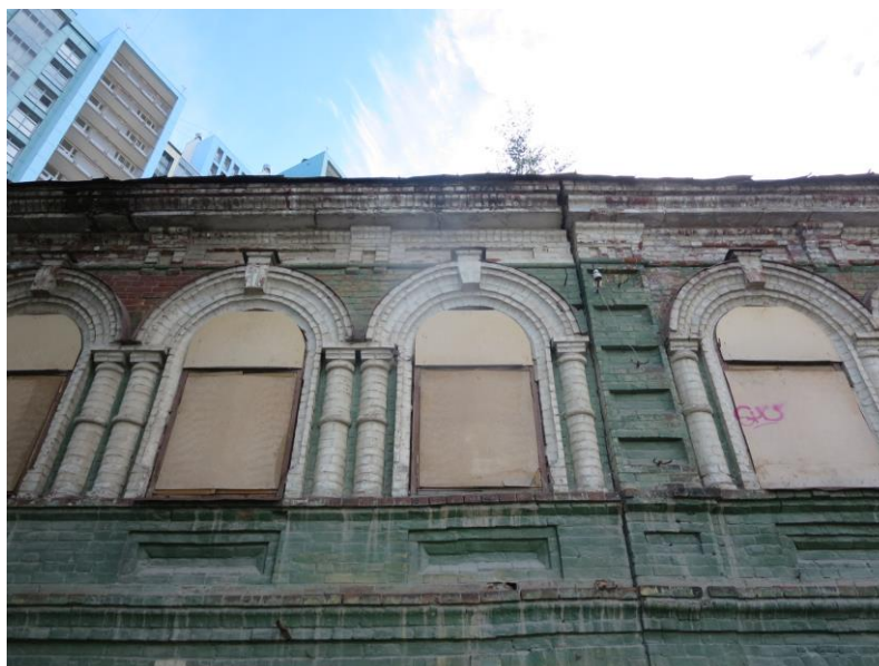
Фото 8. г. Пермь, ул. 25 Октября, 47. «Дом Грацинского». Раскрытие деформационного шва.
