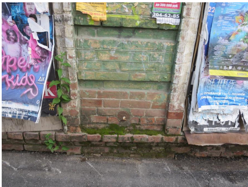
Фото 3. г. Пермь, ул. 25 Октября, 47. «Дом Грацинского». Следы биопоражения цоколя на главном фасаде.
