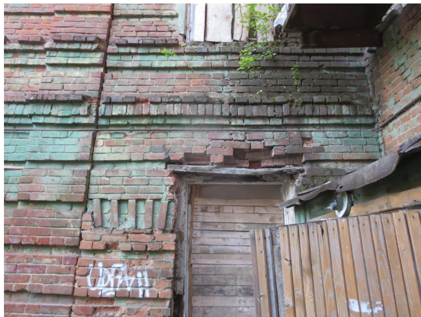
Фото 11. г. Пермь, ул. 25 Октября, 47. «Дом Грачинского». Разрушение кирпичной кладки.
