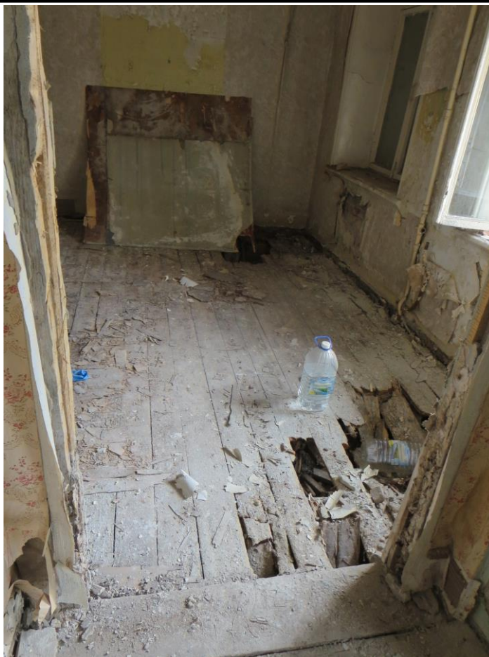
Фото 26 г. Пермь, ул. 25 Октября, 47. «Дом Грацинского». Интерьер. Второй этаж. Помещение 10. Разрушение пола.
