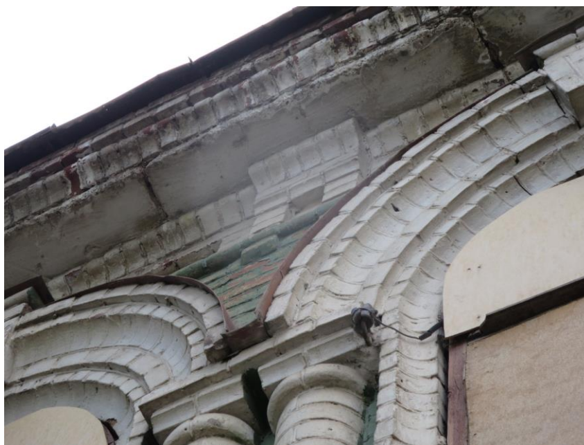
Фото 13. г. Пермь, ул. 25 Октября, 47. «Дом Грацинского». Следы переувлажнения, шелушения покрасочного слоя.
