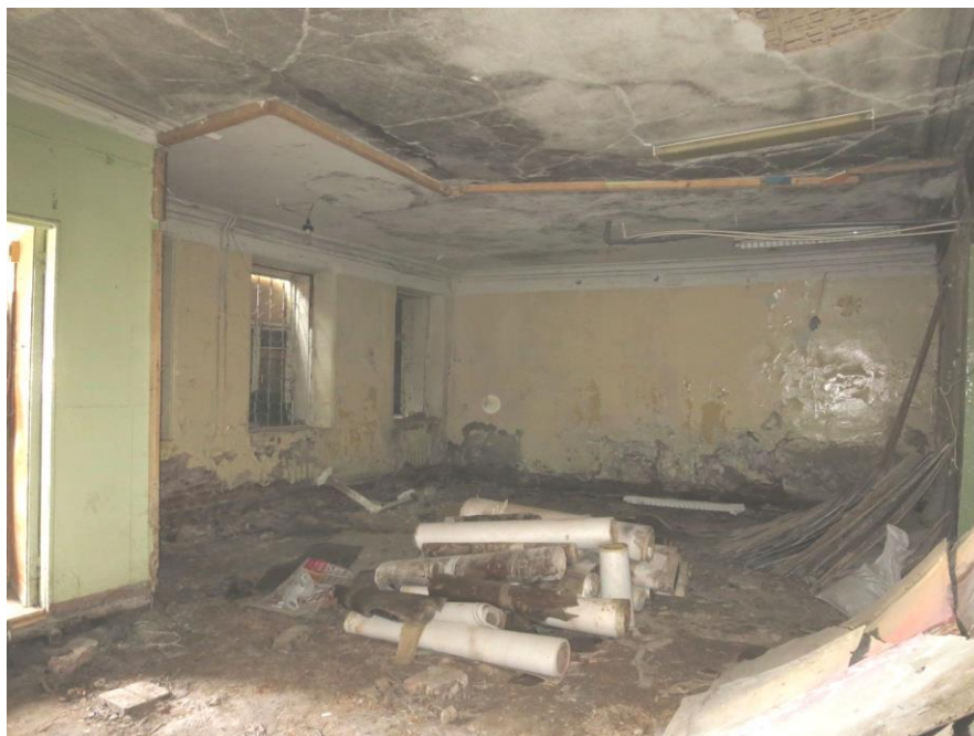
Фото 24 г. Пермь, ул. 25 Октября, 47. «Дом Грацинского». Интерьер. Первый этаж. Помещение 23. Обрушение штукатурки по дранке потолка. Переувлажнение. Прогиб балок перекрытия.
