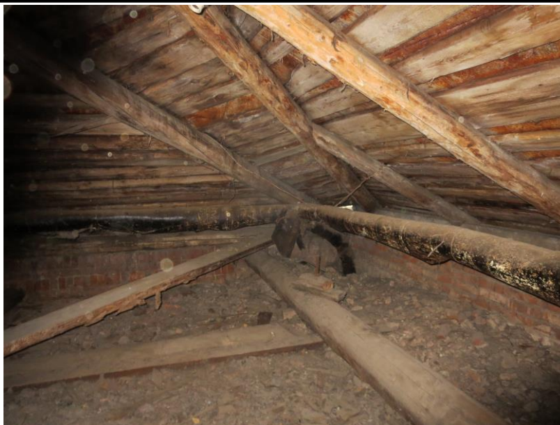
Фото 32 г. Пермь, ул. 25 Октября, 47. «Дом Грацинского». Чердак. Гниение стропильной системы.
