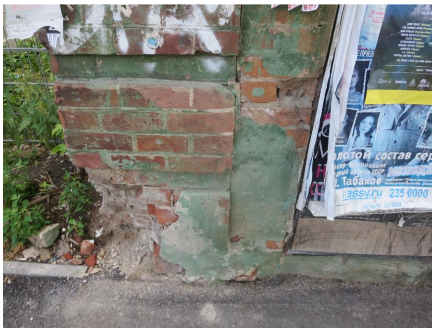
Фото 2. г. Пермь, ул. 25 Октября, 47. «Дом Грацинского». Разрушение цоколя на главном фасаде.
