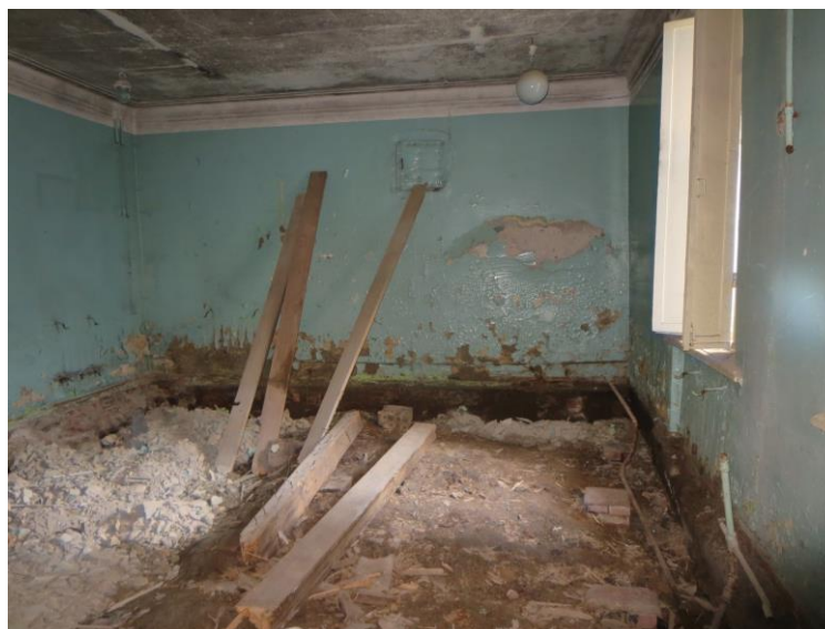
Фото 27 г. Пермь, ул. 25 Октября, 47. «Дом Грацинского». Интерьер. Первый этаж. Помещение 1. Замусоривание, переувлажнение пола.
