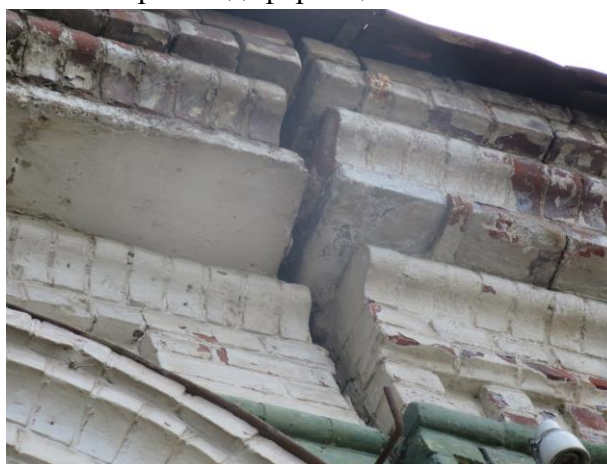
Фото 9. Раскрытие деформационного шва.
