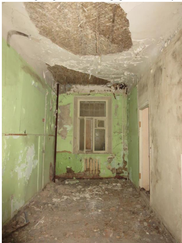
Фото 23 г. Пермь, ул. 25 Октября, 47. «Дом Грацинского». Интерьер. Первый этаж. Помещение 9. Обрушение штукатурки по дранке потолка. Прогиб балок перекрытия.
