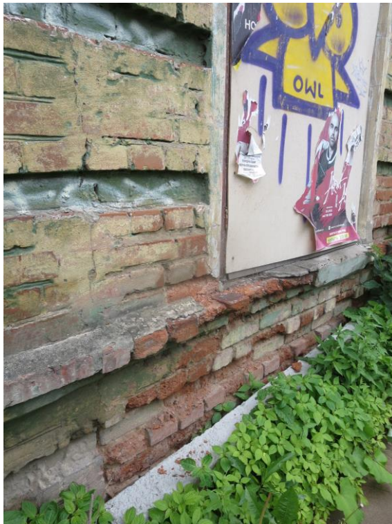
Фото 5. г. Пермь, ул. 25 Октября, 47. «Дом Грацинского». Разрушение кирпичной кладки.
