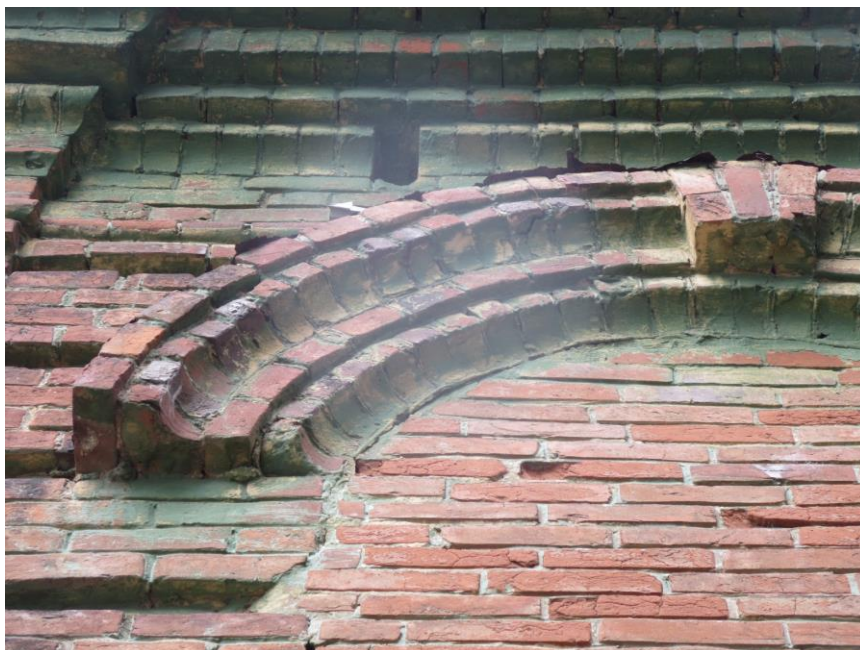
Фото 12. г. Пермь, ул. 25 Октября, 47. «Дом Грацинского». Незащищенные от атмосферных осадков выступающей части декора .
