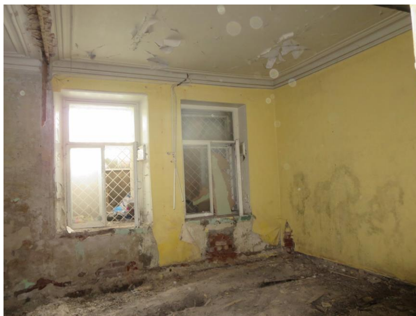
Фото 21 г. Пермь, ул. 25 Октября, 47. «Дом Грацинского». Интерьер. Первый этаж. Помещение 20. Следы отслаивания покрасочного, штукатурного слоев, переувлажнение, биопоражение стен.
