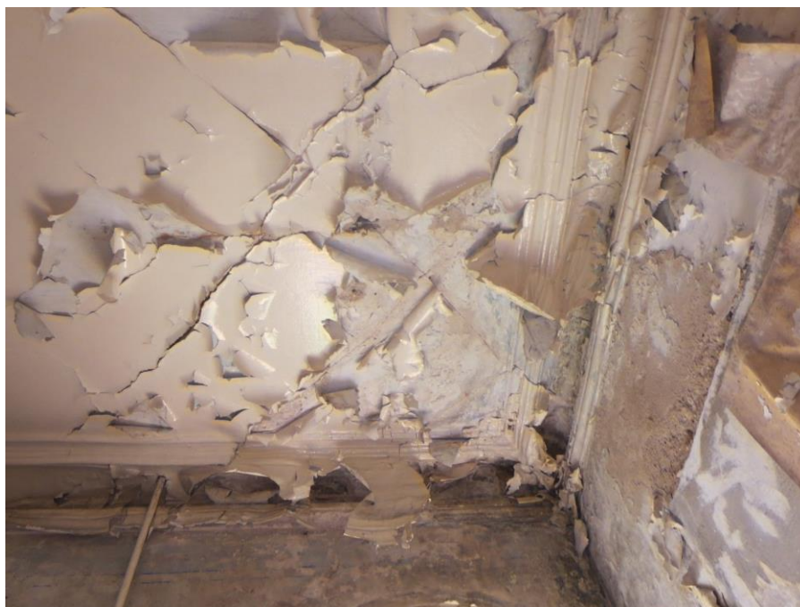
Фото 25 г. Пермь, ул. 25 Октября, 47. «Дом Грацинского». Интерьер. Второй этаж. Помещение 10. Шелушение покрасочного слоя
