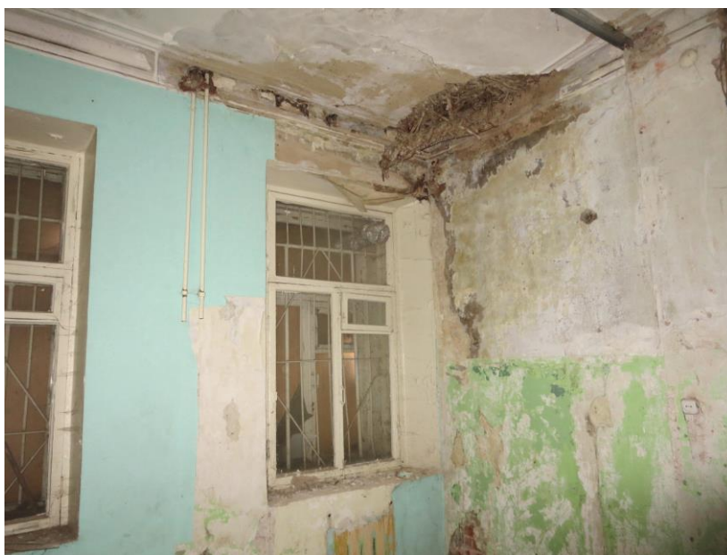
Фото 29 г. Пермь, ул. 25 Октября, 47. «Дом Грацинского». Интерьер. Первый этаж. Помещение 13. Разрушение потолочного профилированного карниза.
