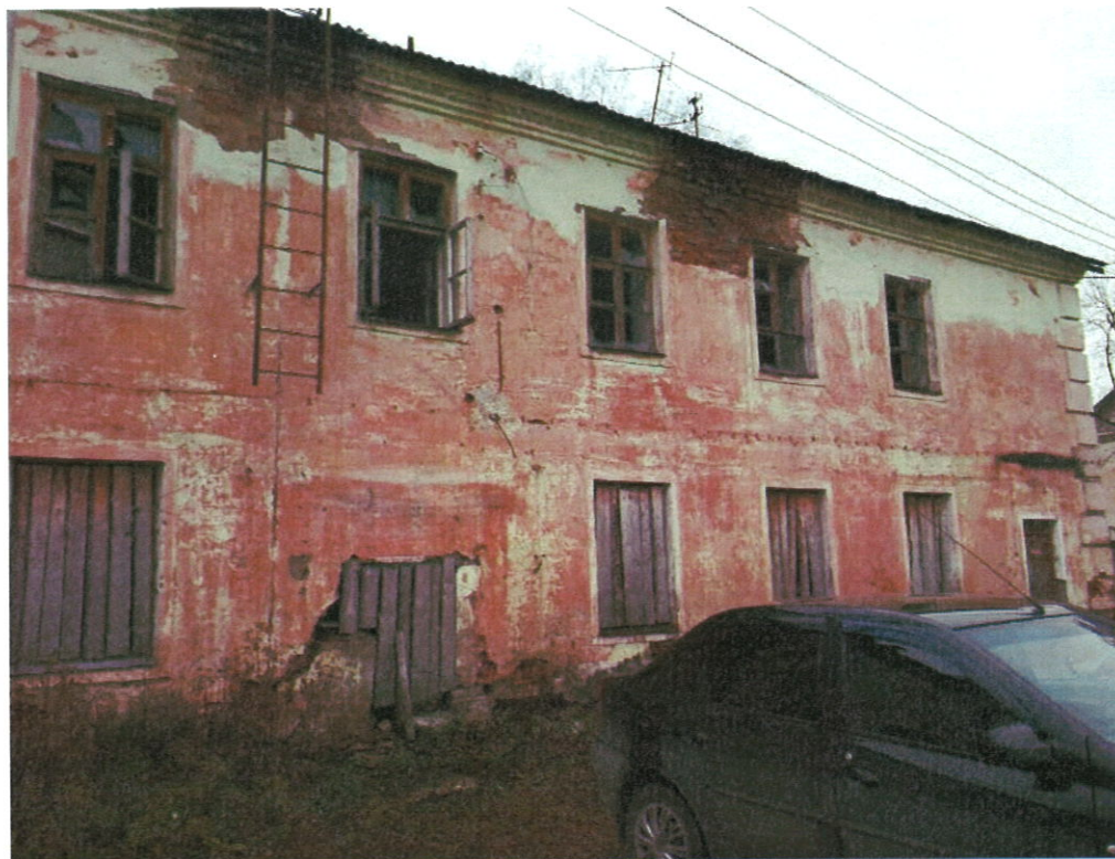
Фото 5 Фрагмент фасада здания. Разрушение штукатурного слоя. Разрушение лакокрасочного покрытия стен. Замачивание кладки стен. Разрушение кирпичной кладки стен на глубину до 250 мм, в т.ч. в месте опирания оконных перемычек. Оконные и дверной проемы защиты деревянными досками. Разрушение остекления. Отсутствие отмоски
