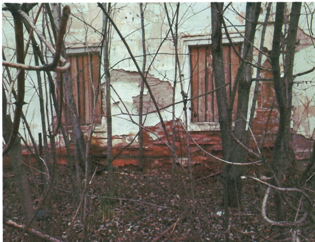
Фото 9 Фрагмент фасада здания. Разрушение штукатурного слоя. Разрушение лакокрасочного покрытия стен. Замачивание кладки стен, произрастание растительности. Разрушение кирпичной кладки стен на глубину до 150 мм. Оконные проемы защиты деревянными досками. Отсутствие отмостки
