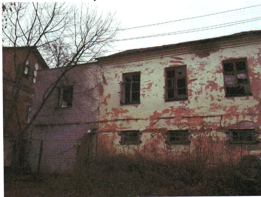
Фото 4 Фрагмент фасада здания. Разрушение штукатурного слоя. Разрушение лакокрасочного покрытия стен. Замачивание кладки стен. Выветривание кладочного раствора. Разрушение остекления. Отсутствие отмостки
