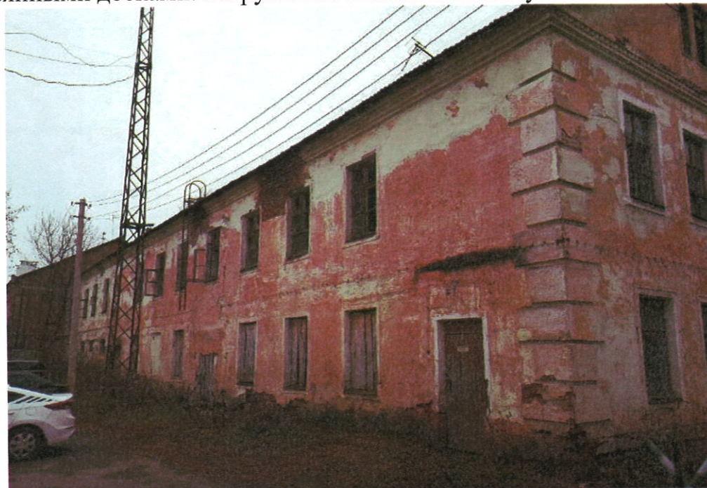
Фото 2 Фасад здания. Разрушение штукатурного слоя. Разрушение лакокрасочного покрытия стен. Разрушение кирпичной кладки стен на глубину до 250 мм. Отсутствие оконных отливов. Оконные проемы защиты деревянными досками. Разрушение остекления. Отсутствие отмостки
