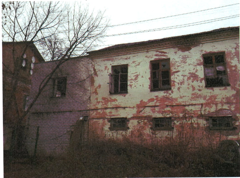
Фото 4 Фрагмент фасада здания. Разрушение штукатурного слоя. Разрушение лакокрасочного покрытия стен. Замачивание кладки стен. Выветривание кладочного раствора. Разрушение остекления. Отсутствие отмостки
