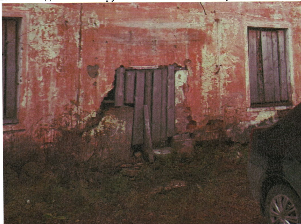
Фото 6 Сквозное разрушение кирпичной кладки
