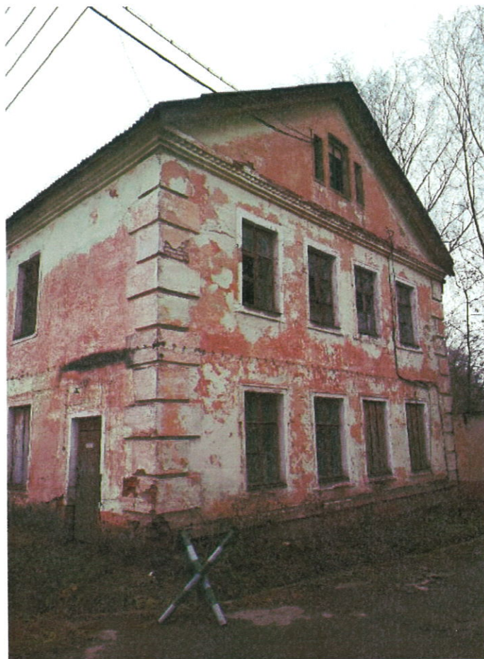
Фото 1 Фасад здания. Разрушение штукатурного слоя. Разрушение лакокрасочного покрытия стен. Разрушение кирпичной кладки стен на глубину до 250 мм. Отсутствие оконных отливов. Оконные проемы защиты деревянными досками. Разрушение остекления. Отсутствие отмостки
