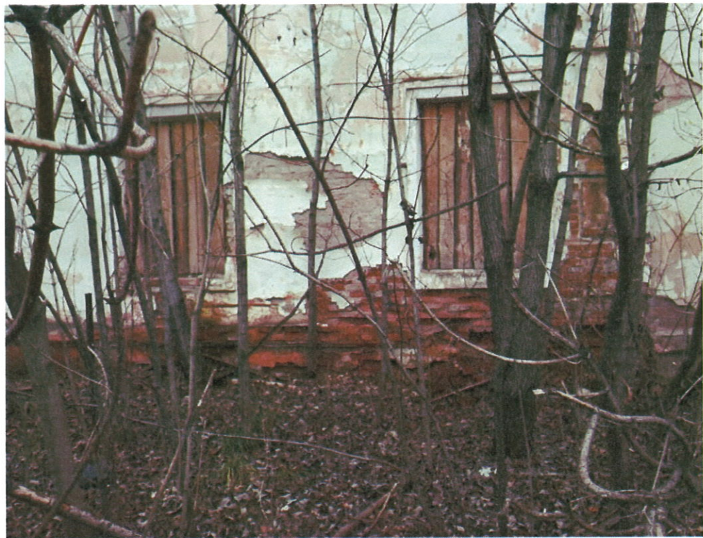
Фото 9 Фрагмент фасада здания. Разрушение штукатурного слоя. Разрушение лакокрасочного покрытия стен. Замачивание кладки стен, произрастание растительности. Разрушение кирпичной кладки стен на глубину до 150 мм. Оконные проемы защиты деревянными досками. Отсутствие отмостки
