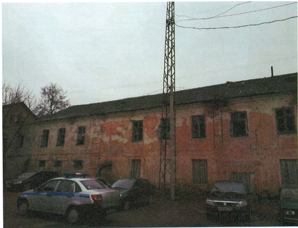
Фото 3 Фрагмент фасада здания. Разрушение штукатурного слоя. Разрушение лакокрасочного покрытия стен. Замачивание кладки стен. Разрушение кирпичной кладки стен на глубину до 250 мм. Оконные и дверной проемы защиты деревянными досками. Разрушение остекления. Отсутствие отмостки
