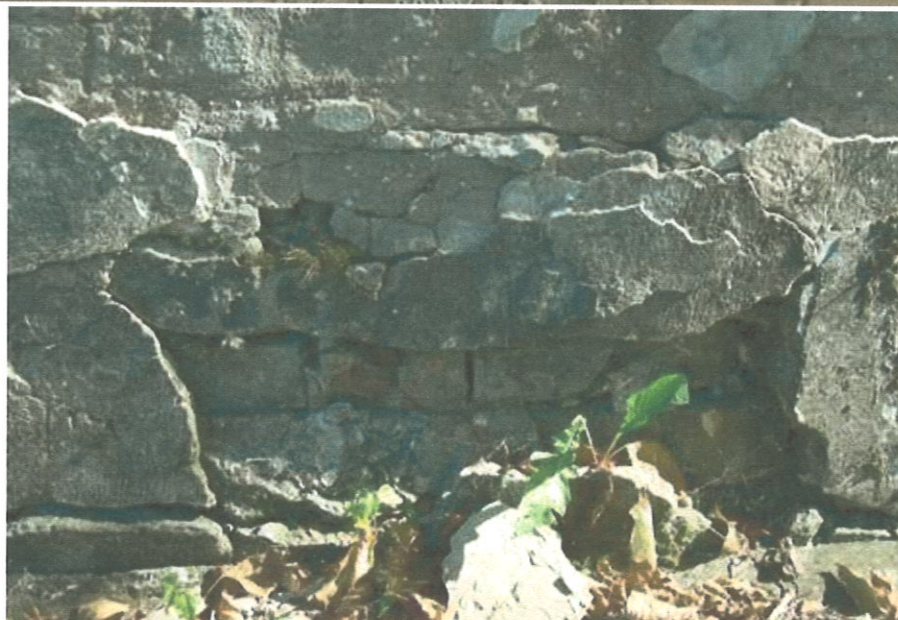
Фото №№ 7-9. Разрушение фундаментов, штукатурных слоёв. Разрушение кровли Раскрашивание, отслоение кирпичной кладки фундаментов и штукатурных слоёв
