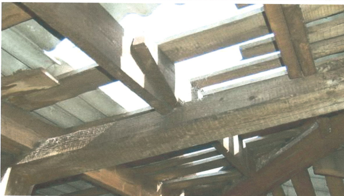
Фото №№ 23-25. Отсутствие асбестоцементных листов и разрушение кровли
