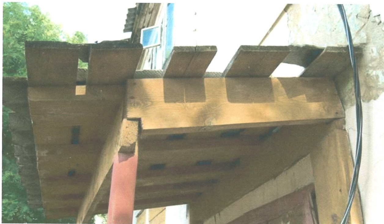
Фото №№ 10-12. Разрушение , раскрашивание, отслоение штукатурных слоёв, разрушение кровли крыльца, биоповреждение внутренних стен, разморозка труб отопления
