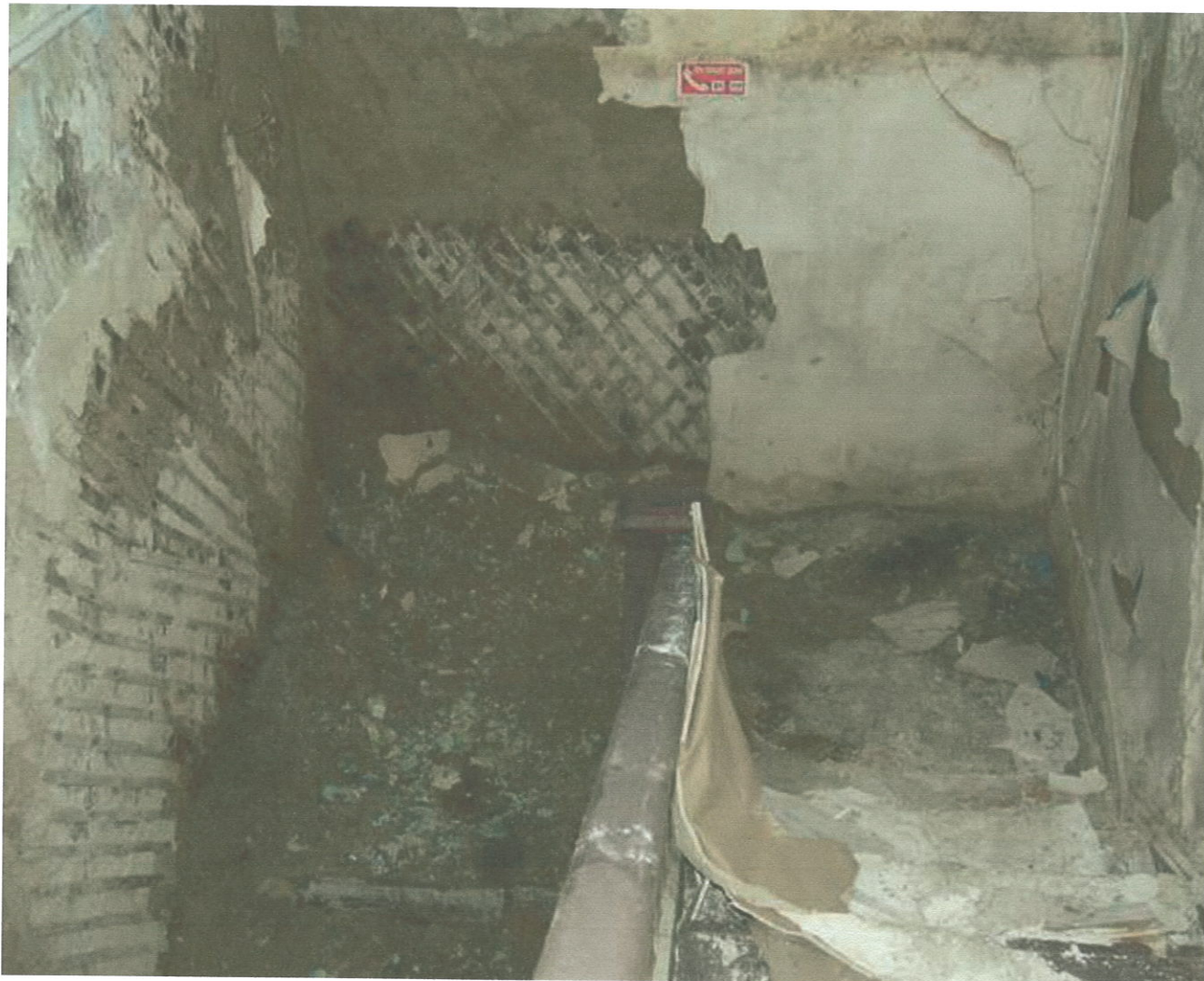
Фото №№ 16-18. Разрушение отделки, штукатурных слоёв потолков, стен.
