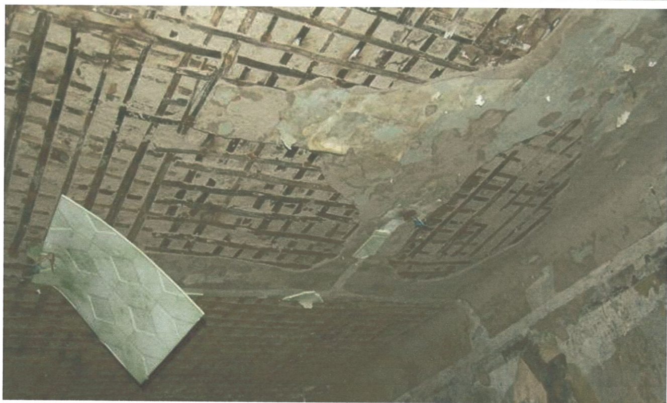
Фото №№ 19-22. Разрушение отделки, штукатурных слоёв потолков, стен. Биоповреждение отделки, древесины стен и перекрытий.
