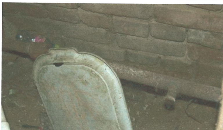
Фото №№ 13-15. Разрушение фундаментов, штукатурных слоёв, раскрашивание, отслоение кирпичной кладки и штукатурных слоёв. Разрушение отделки потолков, биоповреждение древесины перекрытий.
