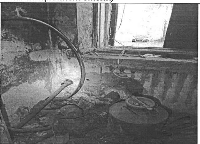
Помещение № 18 – ввод эл.кабеля на общедомовой РЩ (под входным проемом)
