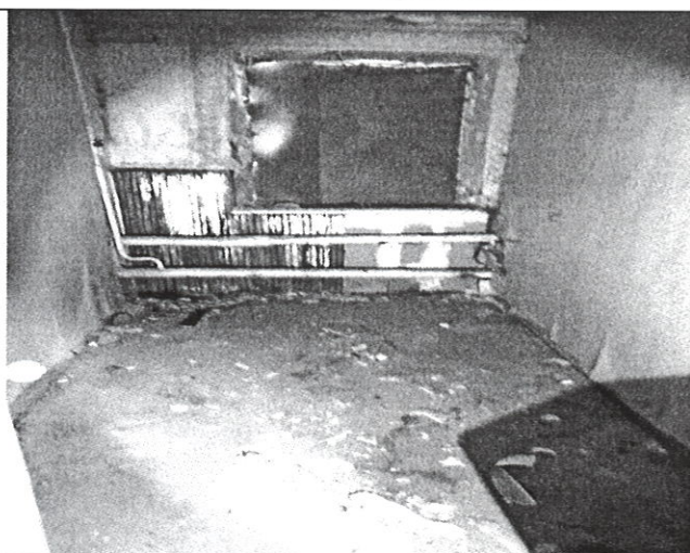
Пом. № 8 ТП от 16.12.2008
