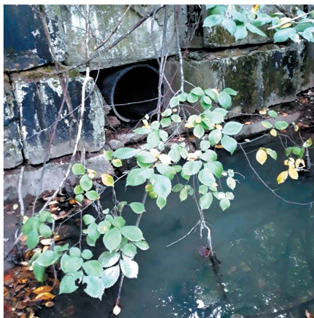
Рис. 3. Водовыпуск в районе дома по ул. Лодыгина, 56/1 (фото от 03.09.2020)
