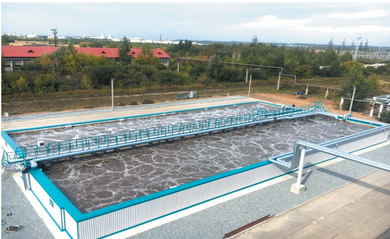
Современные очистные сооружения с блоком биологической очистки сточных вод
